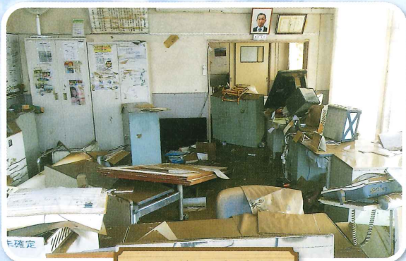
浸水後の事務所
